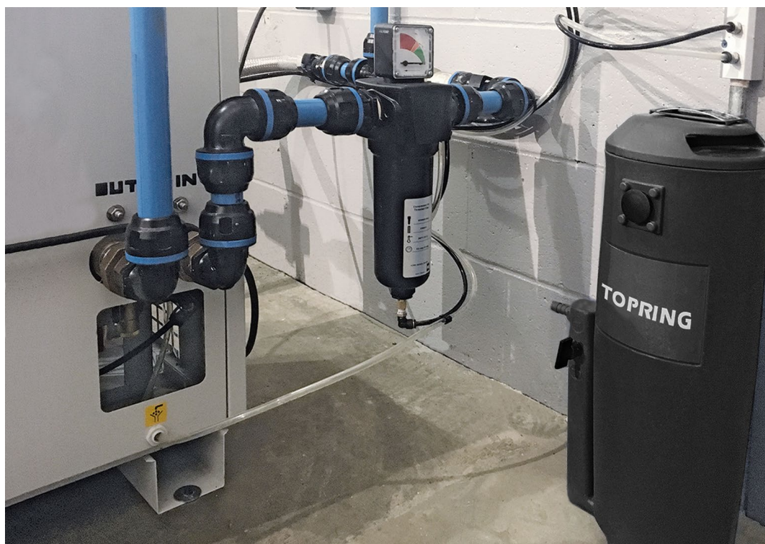
Installation typique d'un séparateur eau/huile HIFLO
